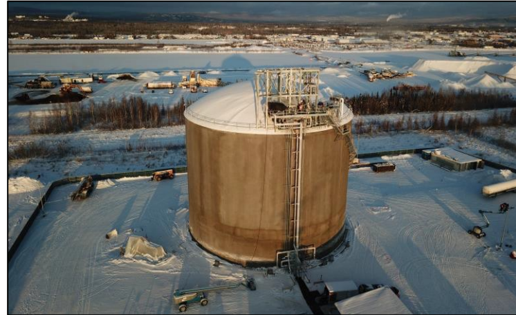
5.25MM Gallon LNG Tank
